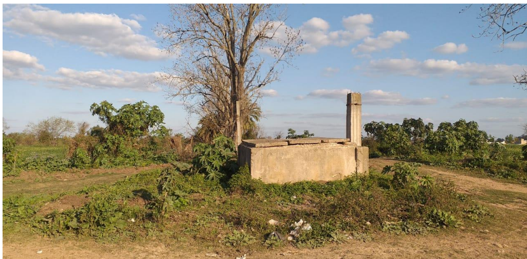
Figura 1 Cámara de ingreso a lagunas existentes.
